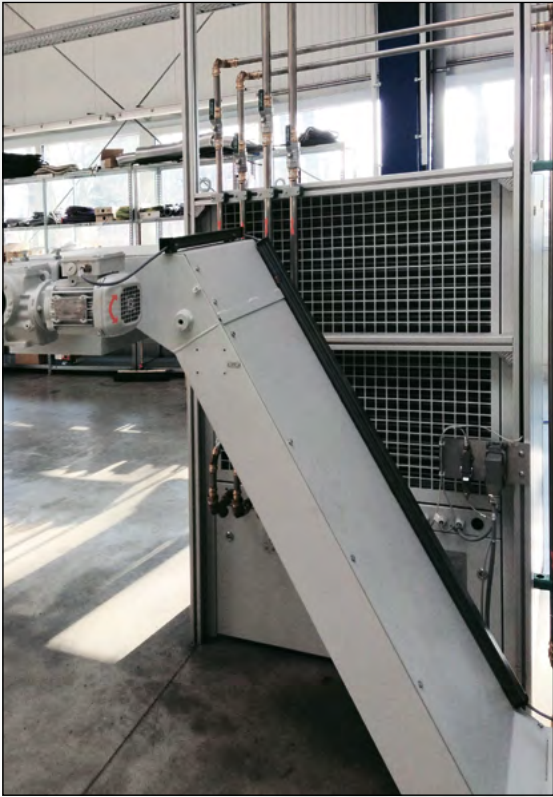
Kühlaggregat und Späneförderer
